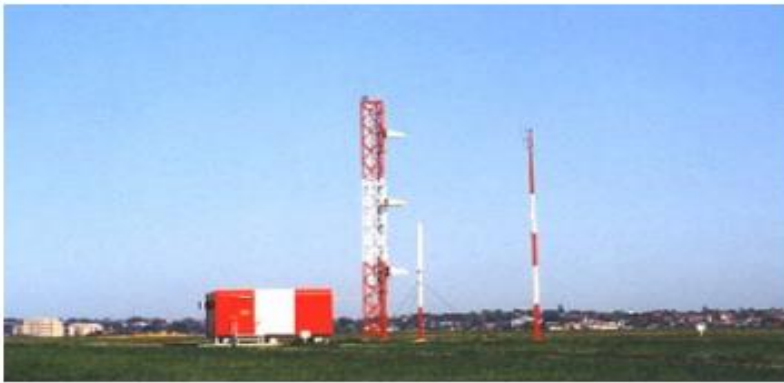
Picture 4. ILS Glideslope Antenna
