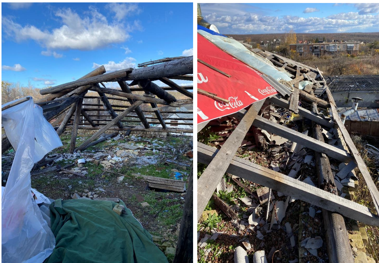
Рисунок 2 – Руйнування елементів покриття та покрівлі.
